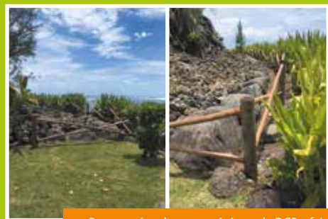
Pour protéger le marae côté mer, la DCP a fait installer une barrière végétale en bois de 'aito.
